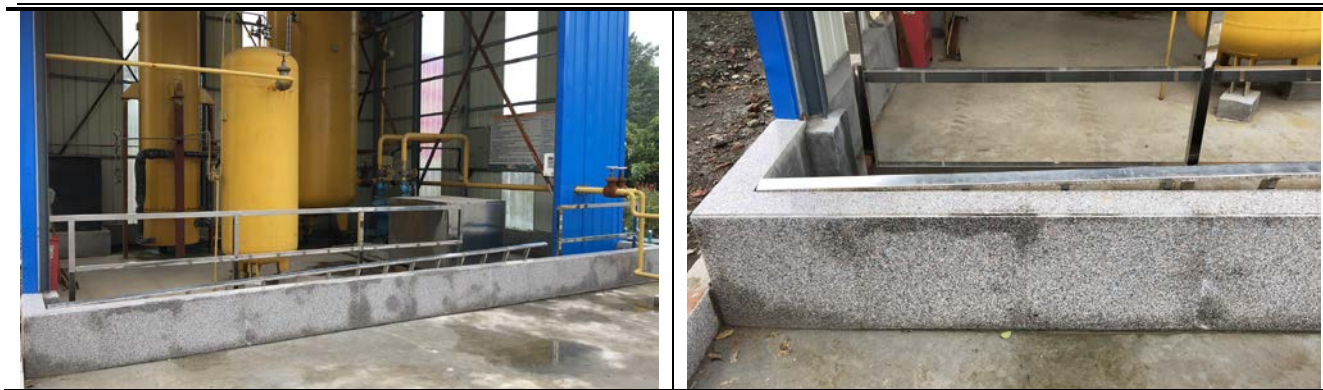
图 4.2-4 液氨储罐区及其围堰照片
