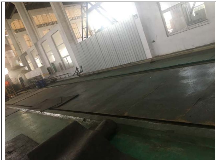
图 4.2-2 事故废水收集池现场照片
