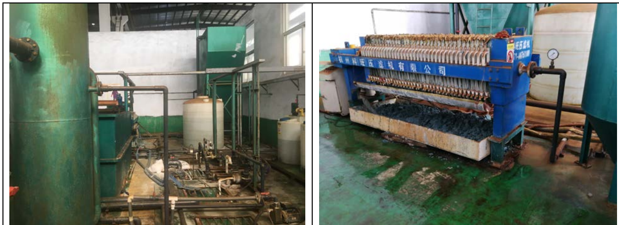
图 4.1-2 废水治理设施图
